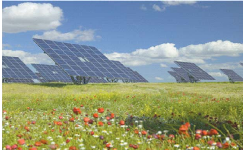
Figura 20. Instalación sobre suelo con sistemas de seguimiento
