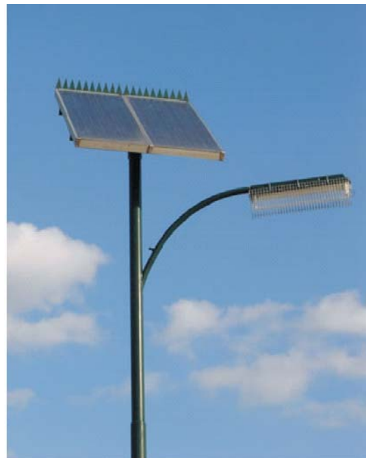
Figura 27. Alumbrado mediante módulo fotovoltaico
