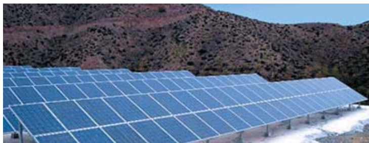
Figura 19. Instalación sobre suelo con paneles fijos
